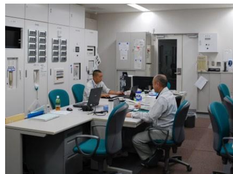
設備の24時間監視
