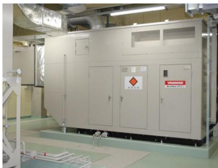
自家発電装置（毎月運転確認を実施）
